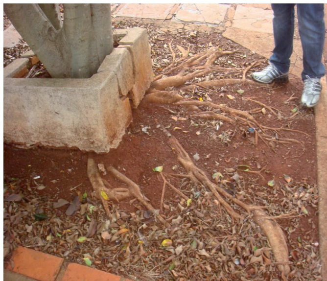
Figura – Raízes com destruição de canteiro
