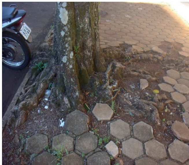
Figura – Raízes destruindo calçadas.
