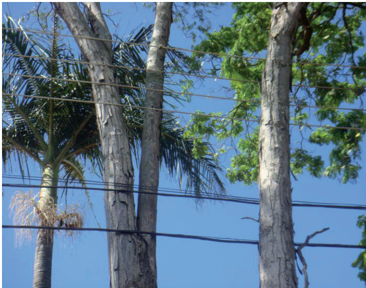
Figura – Árvore em conflito com a rede elétrica.
