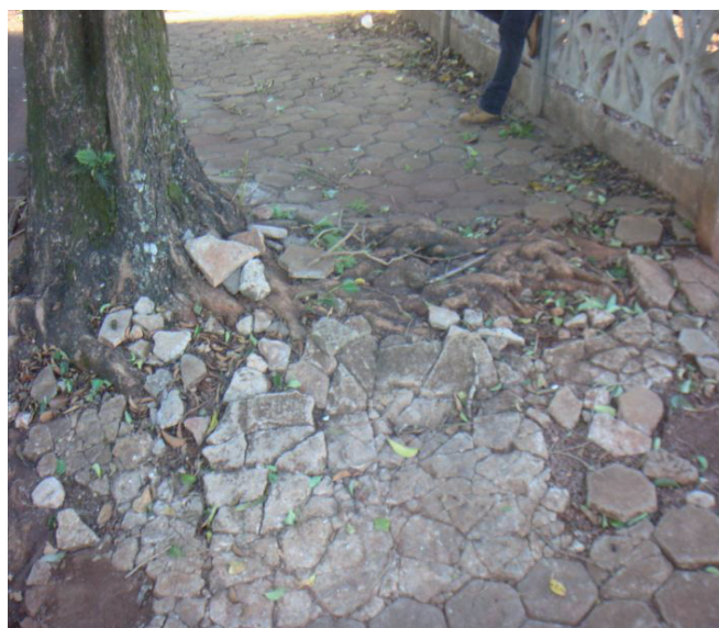
Figura – Raízes destruindo totalmente calçadas.
