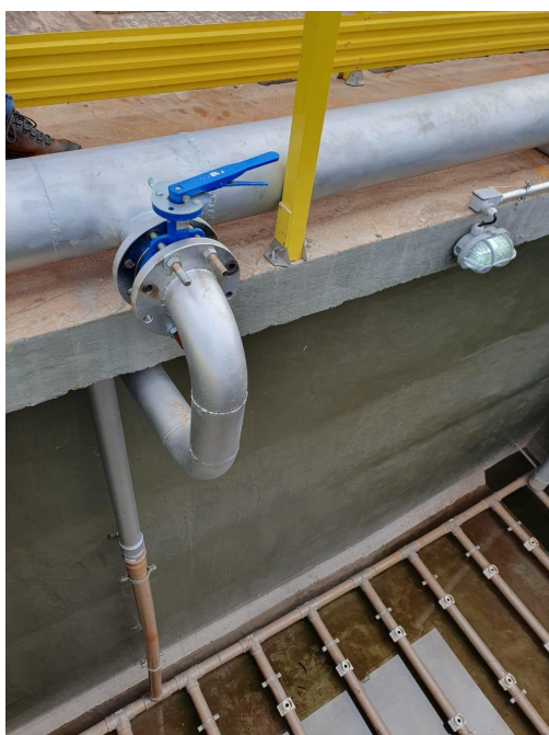
Figura: Tubulação soprador
