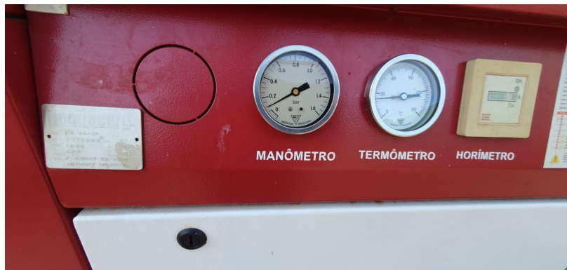
Figura: Soprador II
