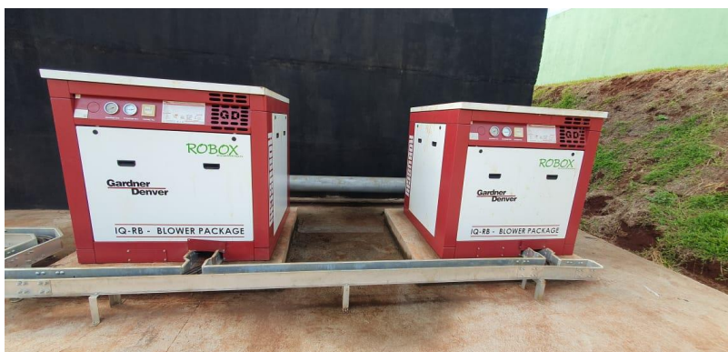
Figura: Disposição dos Sopradores I e II
