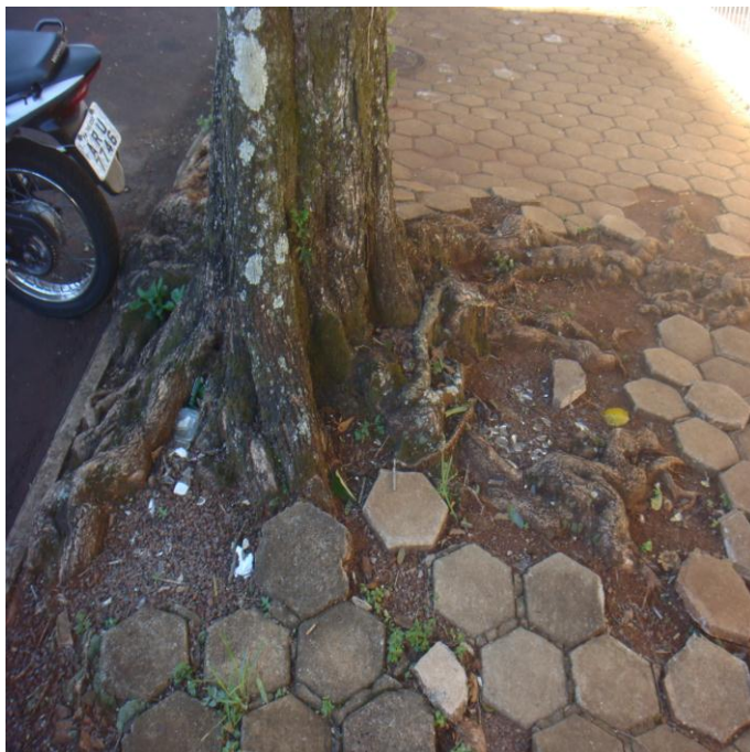
Figura – Raízes destruindo calçadas.
