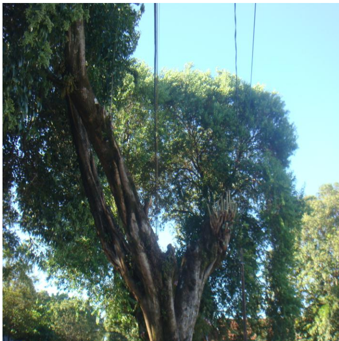
Figura – Árvore em conflito com a rede elétrica.
