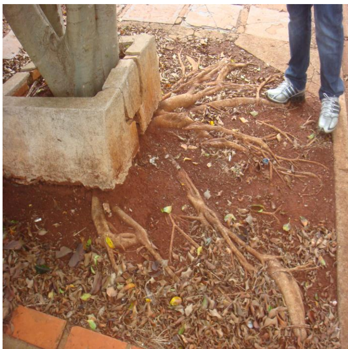
Figura – Raízes com destruição de canteiro
