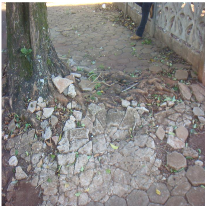
Figura – Raízes destruindo totalmente calçadas.
