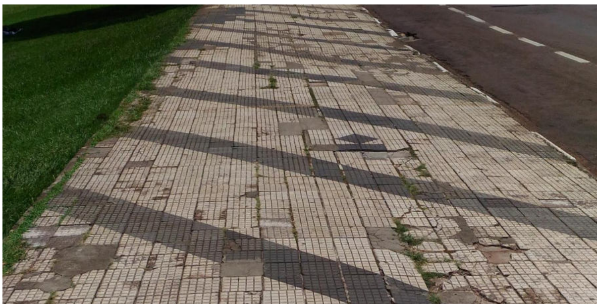
Figura 36 - Calçada danificada na região central
