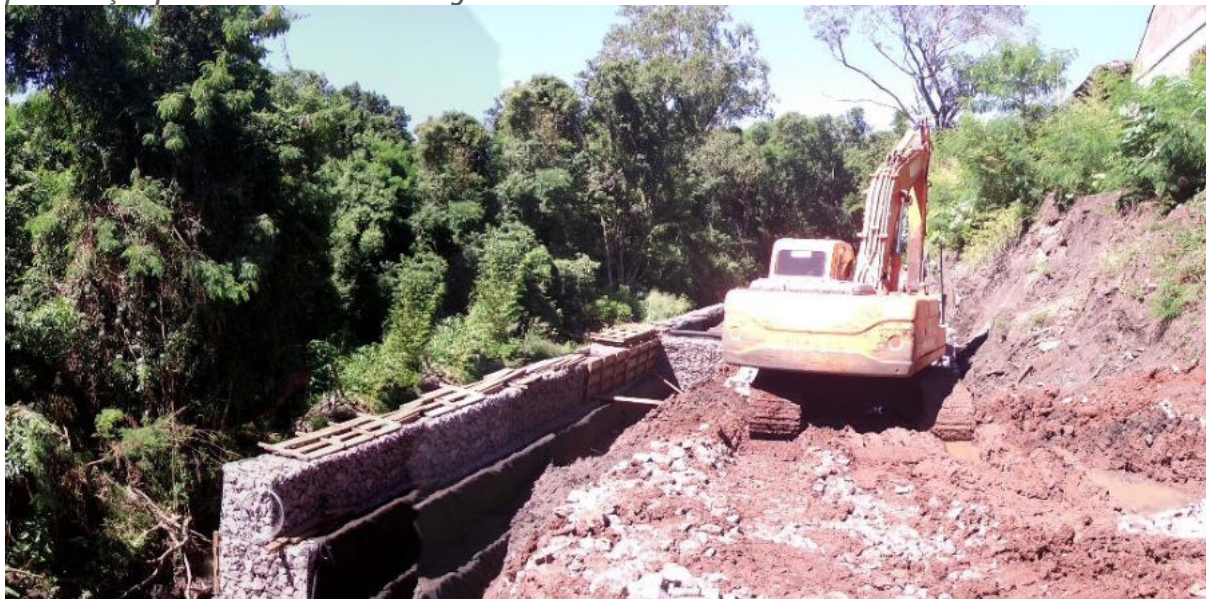
Figura 12 – Construção de muro de contenção junto a instalações comerciais, atingindo a faixa de preservação permanente de curso d'água na área urbana
