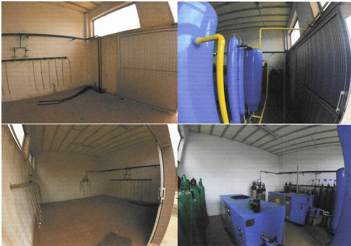
Imagem 3: Foto da central de gases medicinais - Antes e depois
